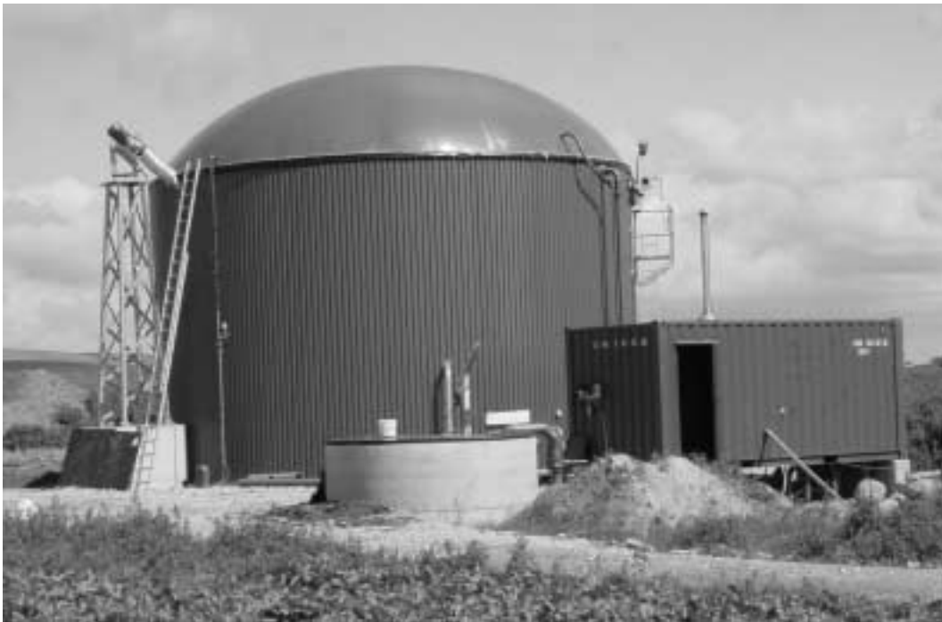
Bild 8. Rötkammare på Hagavik gård med tak av ett dubbelmembran. Till höger syns teknikcontainer som innehåller pump, macerator, gaspanna och styrdator. Blandningsbehållaren är placerad centralt framför rötkammaren. Ställningen på vänstra delen av rötkammaren fixerar rötkammarens omrörare. Foto: Mats Edström
